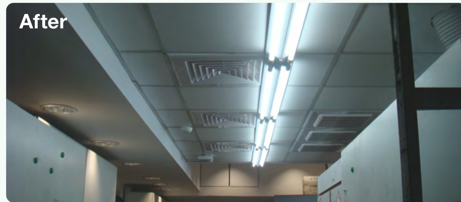
▲ 鍾靈化學館汰換傳統燈具為 LED 燈具汰換後
