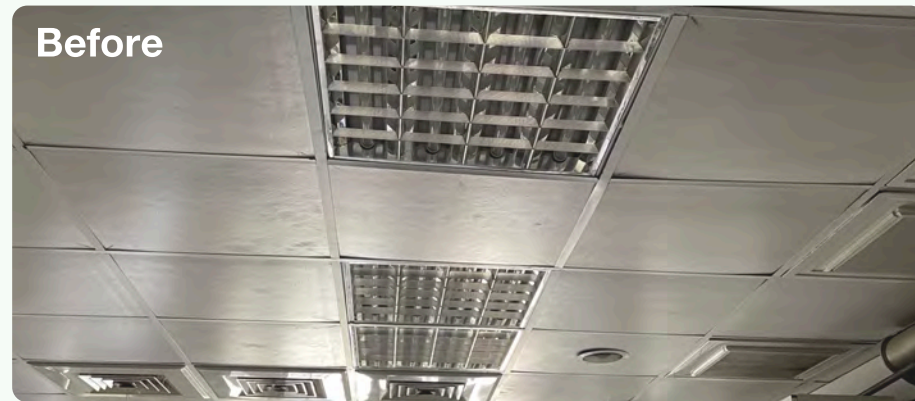
▲ 鍾靈化學館汰換傳統格柵式 T8 燈管汰換前
