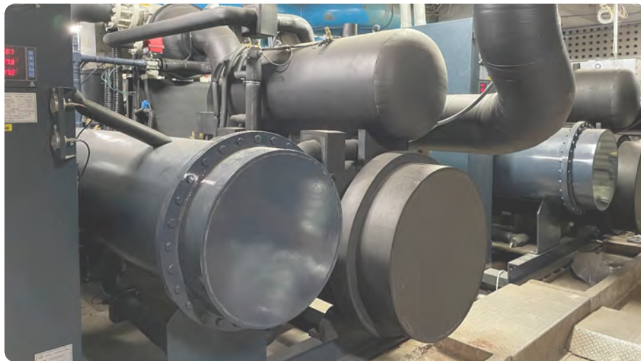
▲ 圖書館新 400RT 變頻磁浮離心式冰水主機
